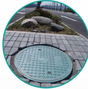
◀下水道相关设施
